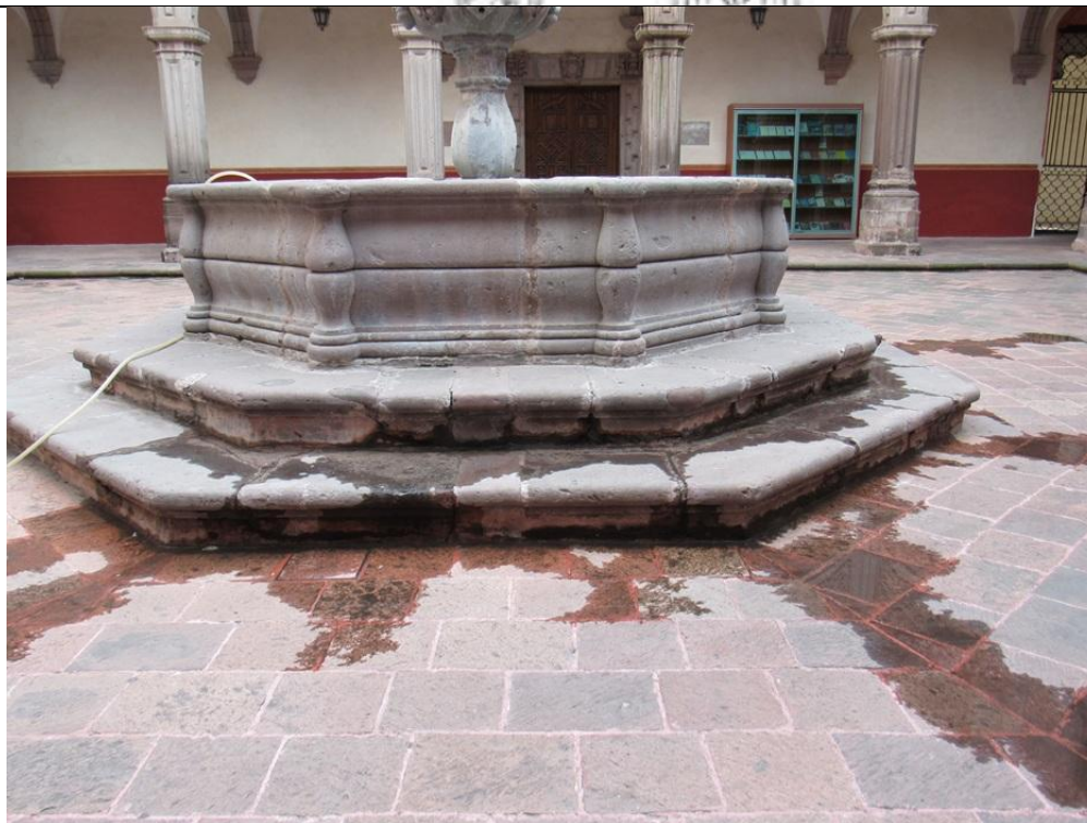
Intervención de la fuente del patio barroco con fugas de agua entre las juntas de la cantera.
